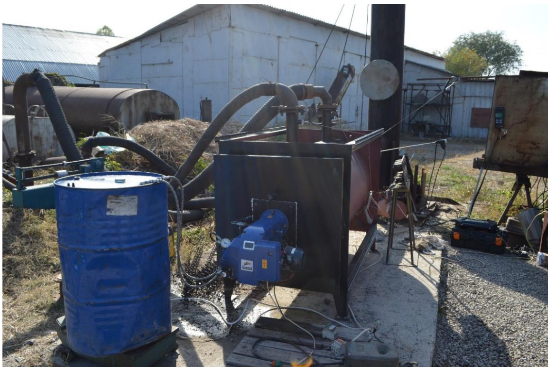
Рисунок 3.9 - Общий вид водогрейного котла ВВ-400 в период подготовки испытаний на комбинированном специальном стенде ТОО «Казкотлосервис»
