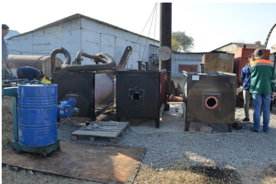
Рисунок 3.8 - Общий вид водогрейных котлов ВВ-400, КВа-400 и КВа-500 в период подготовки испытаний на комплексном специальном стенде ТОО «Казкотлосервис»
