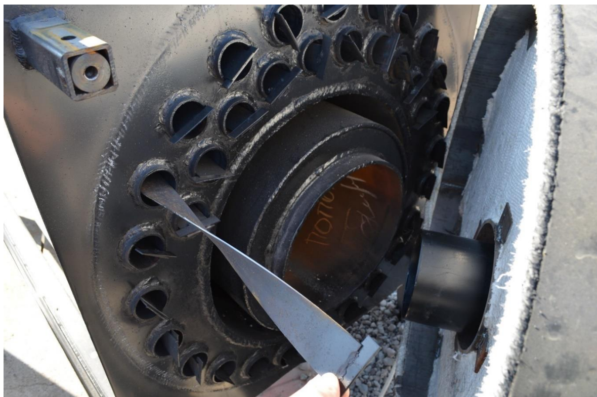
Рисунок Д.3 – Фронтальная часть котла КВа-400 со вставленными витыми ленточными вставками
